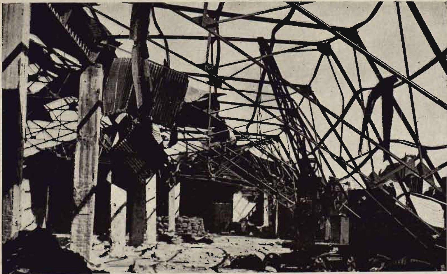
MUELLE DE ESPAÑA DESOLADO ASPECTO DEL TINGLADO N.º 7
