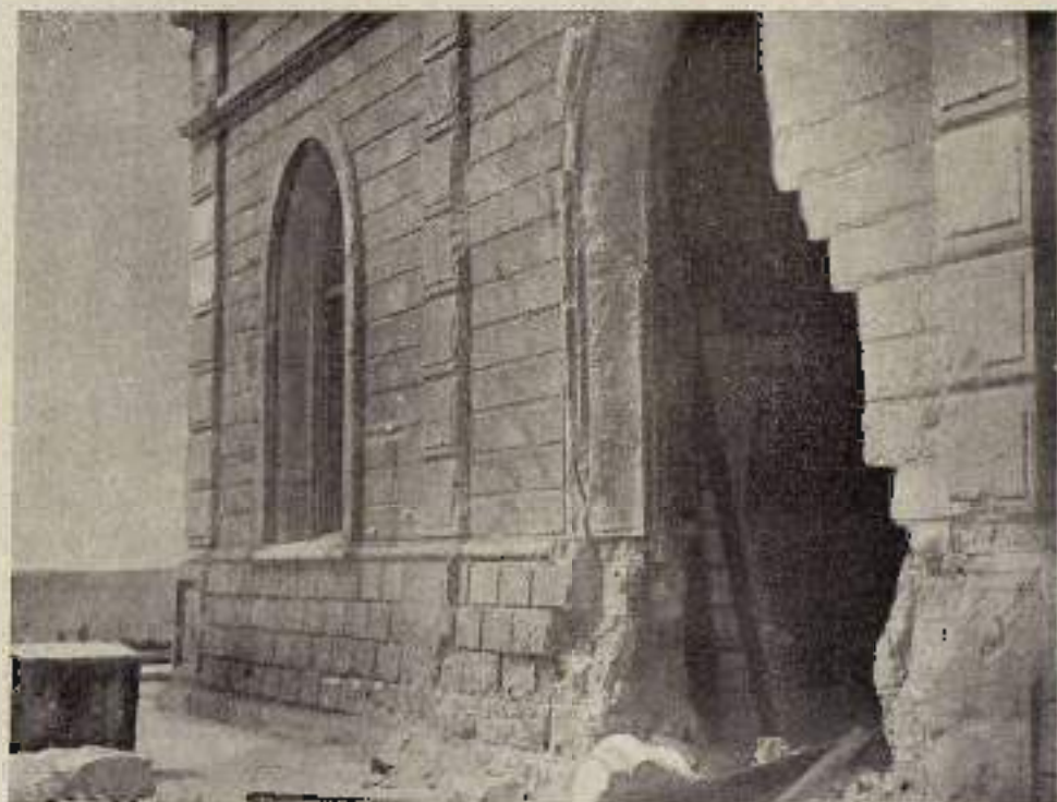
LA VISTA DE LAS DESTRUCCIONES DEL PAGO DEL BOMBEAS
