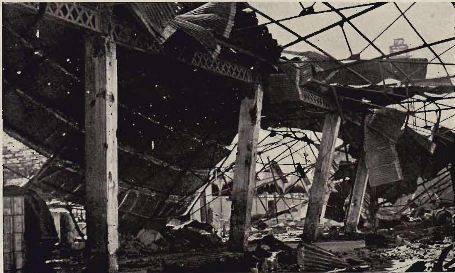
ESTADO DE RUINA COMPLETA DEL TINGLADO N.º 3
