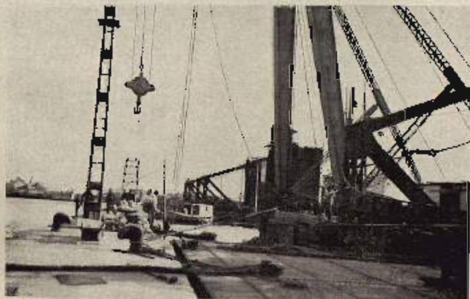
DARSENA DEL BUQUE FLUJANTE PUNTO DE SERVICIO EN REPARACIÓN
