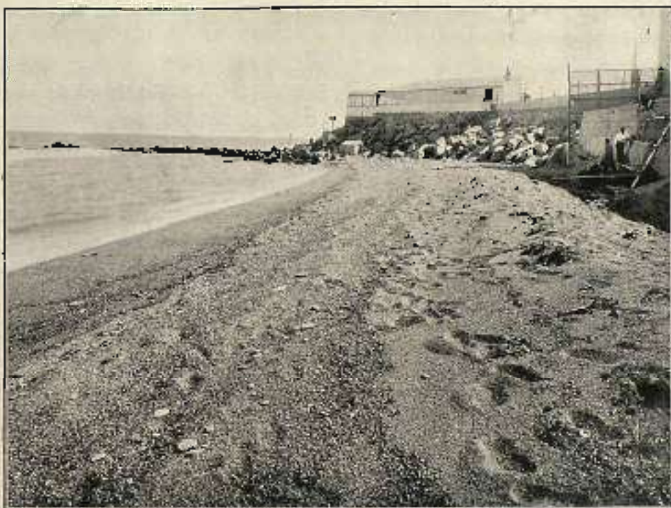
CLAYA FRENTE AL "CERRO NARANJO BARCELONA" DURANTE LA CONSTRUCCIÓN DEL ESTACION DE LA GLOSETA DEL TOMPONES
