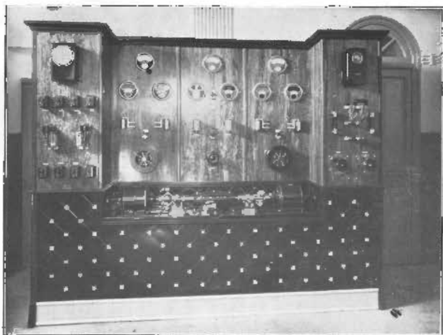
INSTALACIÓN DE LA LUZ ELÉCTRICA EN EL MÓDULO DEL FORTÍFICO Y EN EL FARO. CUADRO CON LOS DISYUNTORES APARATOS
