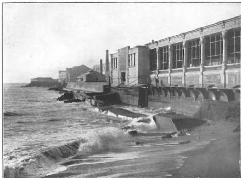
DESPÉRFECTOS PRODUCIDOS EN EL MURO DE DEFENSA DE LA ZONA DEL GRAN BAÑERÍA CASINO, POR LA MAREJADA DEL SUR DE NOVIEMBRE DE 1925
