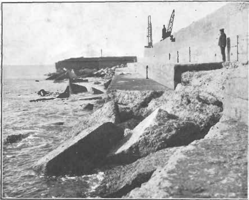
DESPERFECTOS OCURRIDOS EN LAS BANQUETAS EXTERIORES CERCA DEL EXTREMO Y EN EL MORRO TERMINAL
