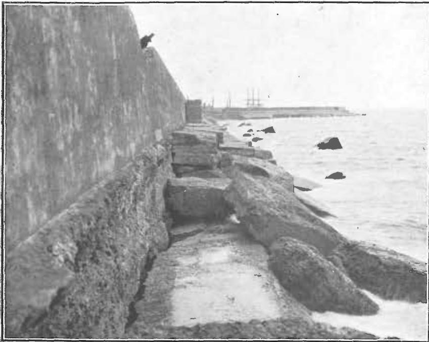
DESPERFECTOS OCURRIDOS EN LAS BANQUETAS EXTERIORES CERCA DEL ORIGEN
