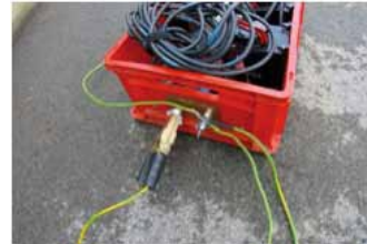
Caja de puesta a tierra
