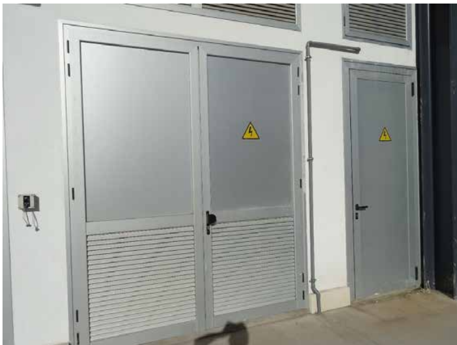
Ilustración 30. Centro de Transformación y Grupo Electrónico, entrada en el frente del edificio de Terminal de cruceros. Fuente: Elaboración propia
