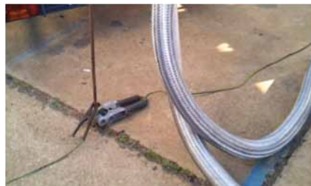
Fig. 10. Puesta a tierra de cisternas de GNL antes del trasvase. (Foto cortesía de ESK)
