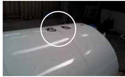
Válvulas de sobrepresión del depósito
