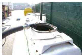
Depósito de "lavado" de gases.
