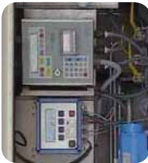
CONTROL DE LA BOMBA
