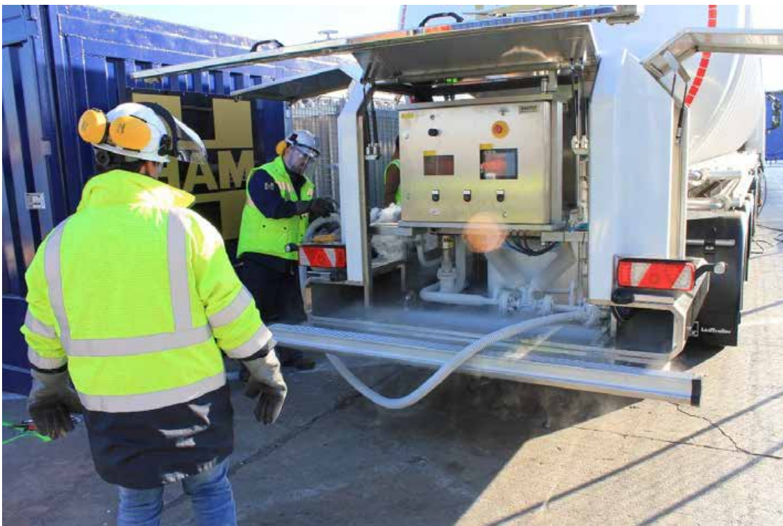
Figura 124. LNG hose disconnection.
