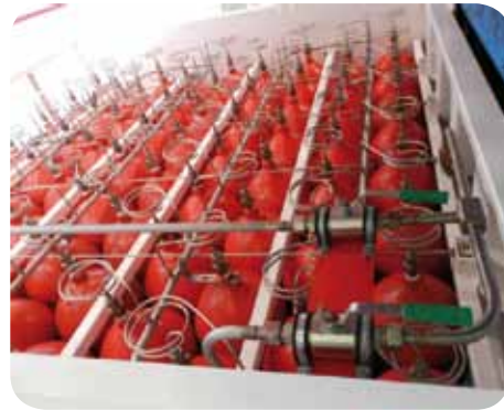
VÁLVULAS DE MÓDULOS
